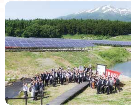
年間約5,700世帯分の電気をつくり、約9,200トンのCO 2 削減につながっています
