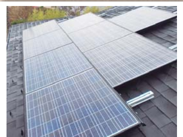
WCAの特別融資で4kWの太陽光発電を設置した鎌倉市T邸
