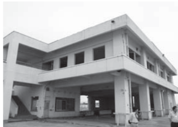
ガラスが飛び散り、空洞化した事務所
