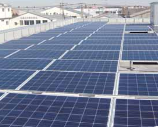
あやせ総合センター 太陽光パネル
